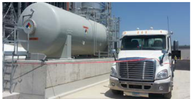
Un indicateur de niveau magnétique à haute visibilité avec transmetteur magnétostrictif soutient le déchargement d'ammoniaque dans une centrale électrique à cycle combiné.
