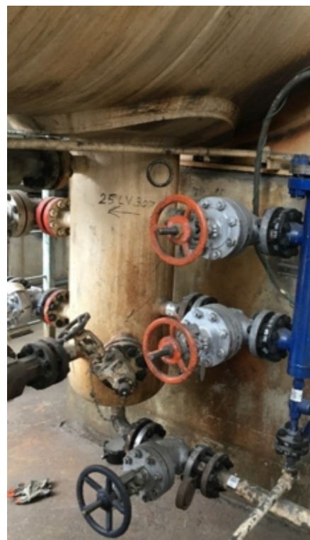
Abbildung 9: Boot zur Abscheidung in einer Raffinerie (GWR-Messumformer installiert im blauen Bezugsgefäß rechts)
