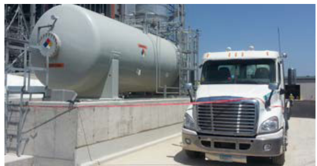
Magnetklappenfüllstandanzeiger mit hoher Sichtbarkeit mit magnetostruktivem Messumformer unterstützt die Entladung von Ammoniak in einem Kombikraftwerk
