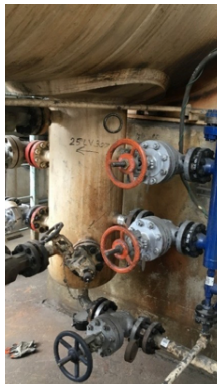
Figura 9. Tubo separatore in una raffineria (il trasmettitore GWR è installato nella camera blu a destra)
