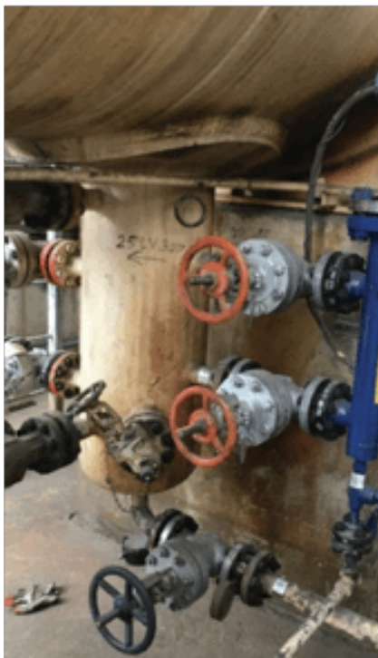
Нефтеперерабатывающая установка с отстойником в виде сепаратора сред типа «жидкость-жидкость»
