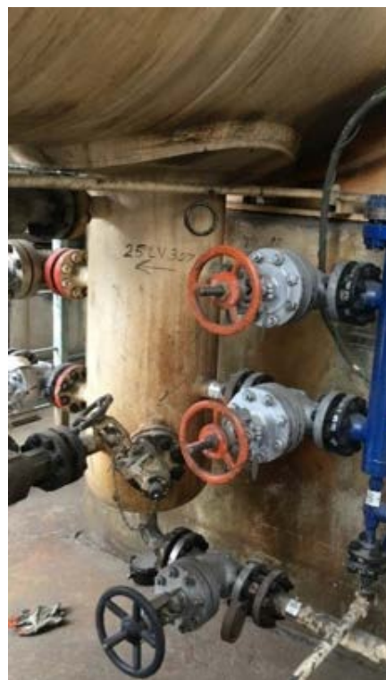
Figura 9: Bota de separación en refinería. El radar de onda guiada está instalado en la cámara azul de la derecha.
